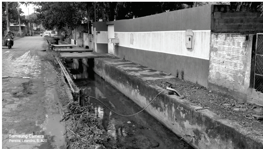
Figura 3: Bairro Cristo Redentor: esgoto corre a céu aberto
